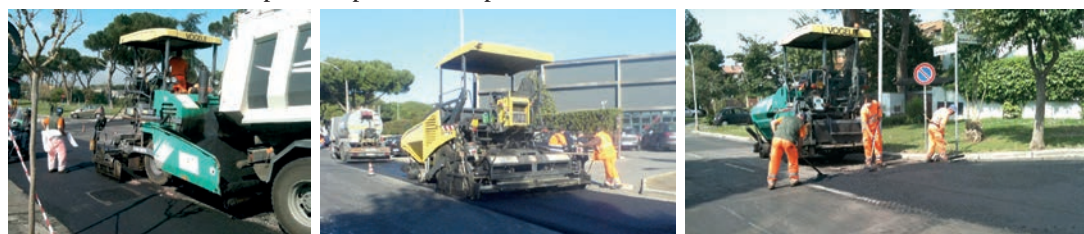
Da sinistra i lavori a Piazza Eschilo, a via Eschilo e a via Sofocle
