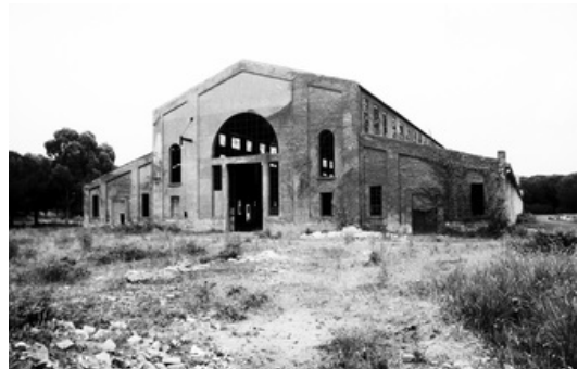
Lo scheletro del complesso della Meccanica Romana prima della sua trasformazione nell'odierno Cineland
